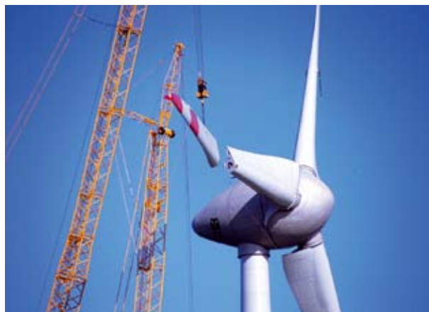
Die leistungsstärkste Windturbine der Welt wurde Ende 2007 auf dem Rysumer Nacken errichtet.
