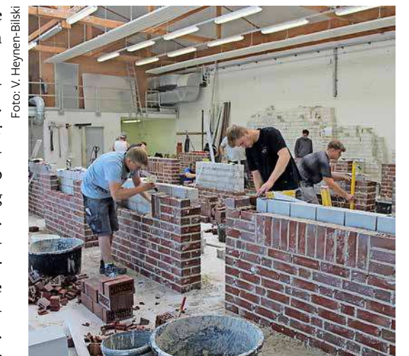
Kamen während ihrer praktischen Prüfung mächtig ins Schwitzen: Die neuen Maurergesellen des Jahrganges 2023.
